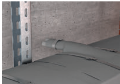
Кабельный вывод с бандажированием.
