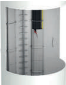
Бандажированная вертикальная трасса в башне ветросиловой установки.
