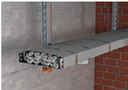
Полное бандажирование подвесной кабельной трассы.
