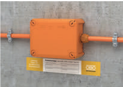
Установленная огнестойкая распределительная коробка FireBox с маркировкой.
